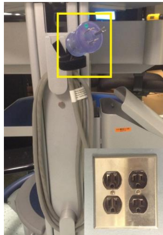
Prise et câble électrique
